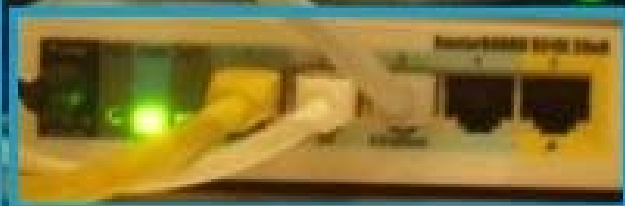
Routeur Mikro Tik réseau Hamnet gestion réseau et VPN
