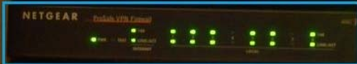
Routeur firewall/VPN Réseau des serveurs virtualisés
